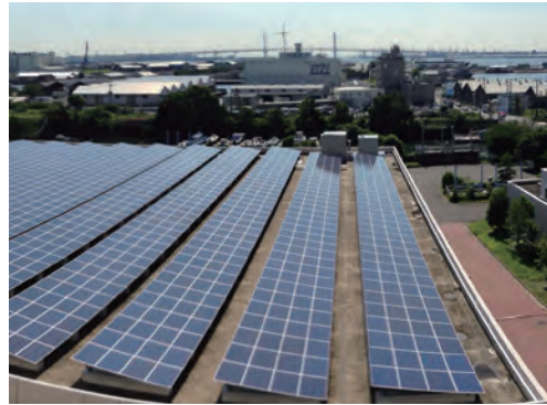
下水処理施設の上部空間を活用した 太陽光発電（神奈川水再生センター）
